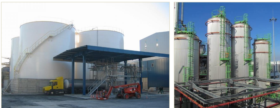
Figura 2-32 – Tanques de armazenamento (Cortesia da Fábrica Biovegetal e da Fábrica Prio)
