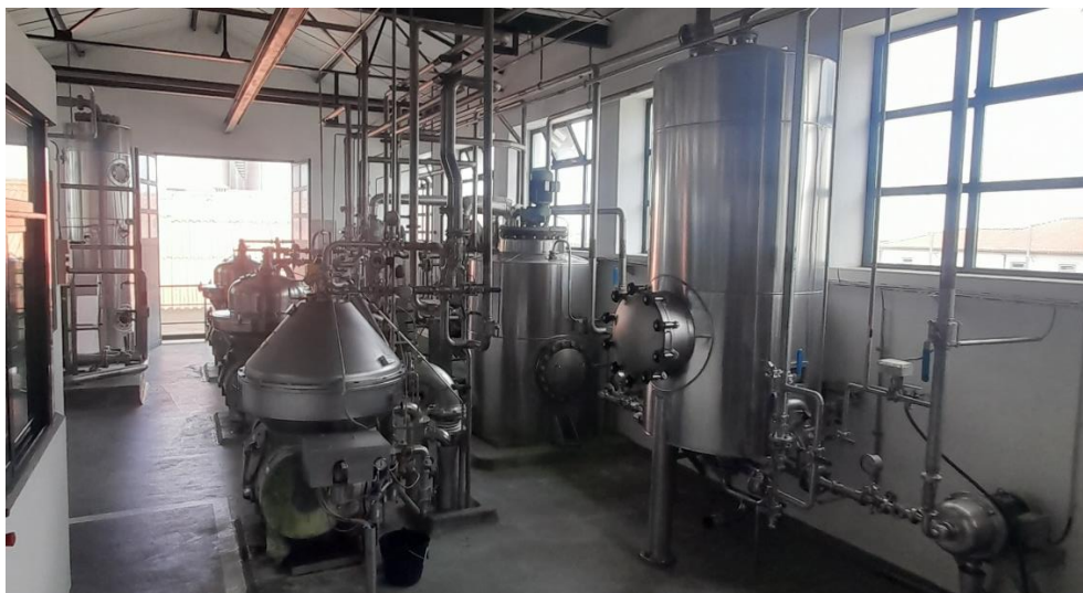
Figura 2-12 – Reatores e centrífugas do processo de neutralização de óleos vegetais (Cortesia da Fábrica Torrejana)
