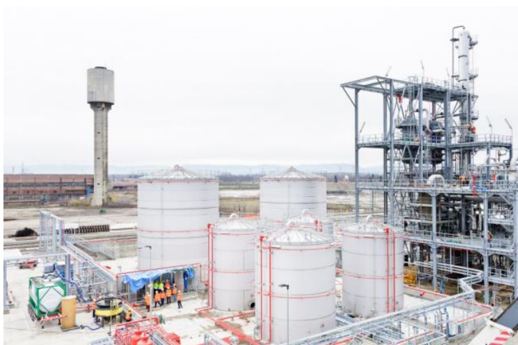
Figura 4-49 – Unidade de destilação e armazenamento de bioetanol [301]
