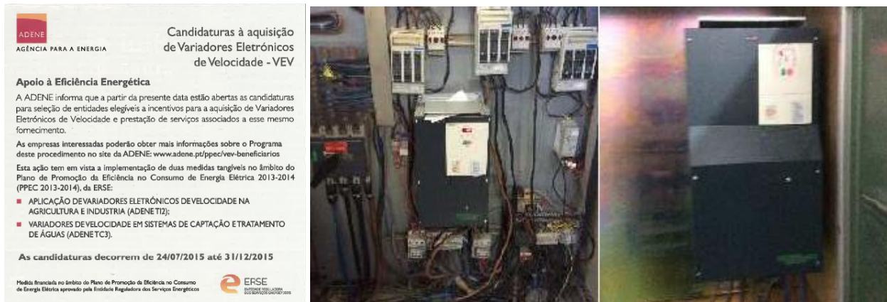
Figura 2-6 - Imagens da implementação da medida ADENE_T12
