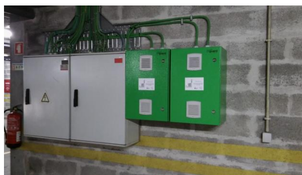
Otimizador de Energia instalado no Parque de Estacionamento do Mercado Municipal de Torres Vedras
