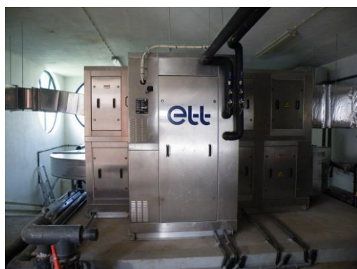
Nova UTAD instalada na Piscina Municipal de Alvaiázere
