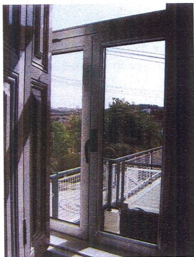
Figura 3. Exemplo de janela com bom isolamento e sombreamento interior
