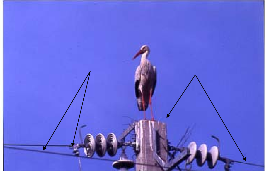
Cegonha Branca ( Ciconia Ciconia ) pousada num apoio tipo GAN, com elevado risco de electrocussão entre fases e entre fase e neutro no apoio.
